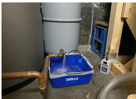
Mahutite tühjendamine ning vee ärajuhtimine kanalisatsiooni
